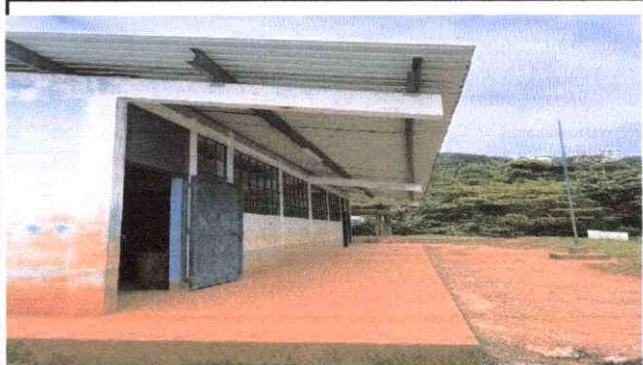
Foto # 1 Canales y bajadas de agua para aguas fluviales.
